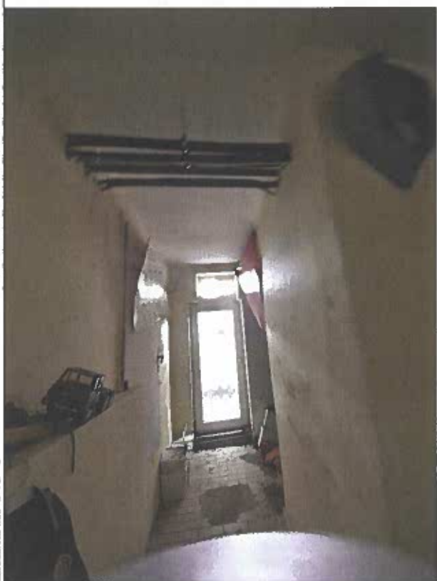
11. нарушена подова настилка
