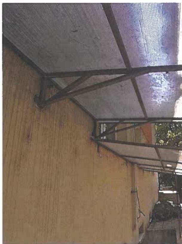
24. фасадно замърсяване от дъждовна вода
