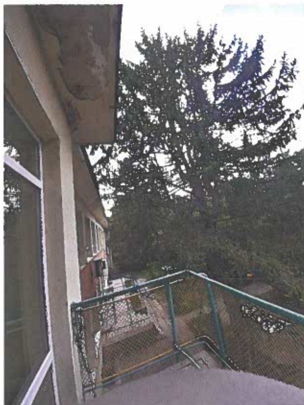
16. обрушена мазилка под стреха
