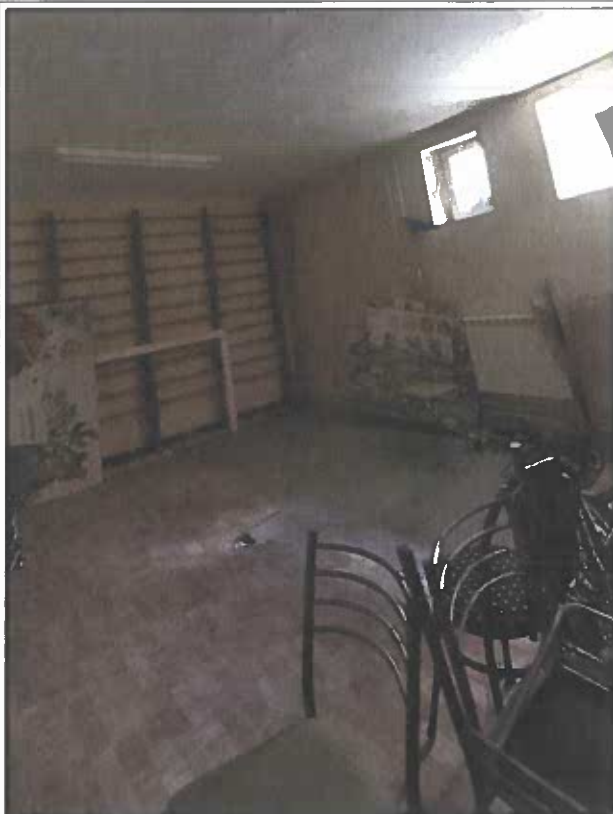
05. нарушена подова настилка
