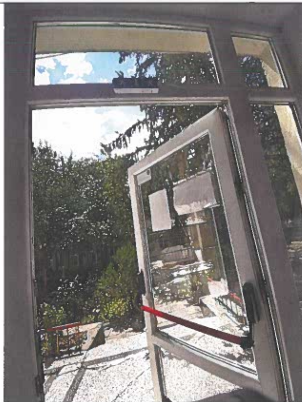
22. нарушена подова настилка
