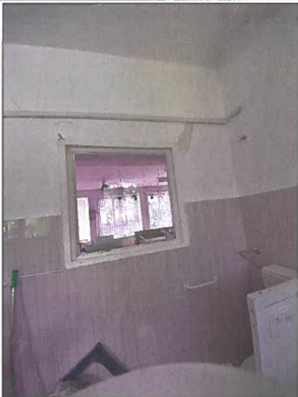
21. пукнатини в мазилка
