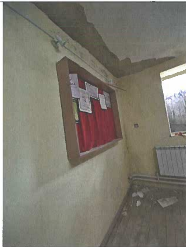
10. обрушена интериорна мазилка
