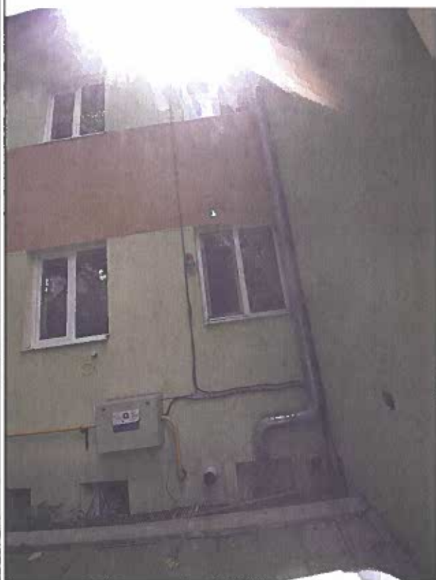
27. нарушения в мазилка
