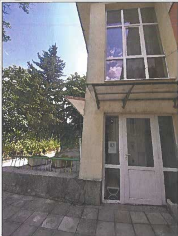
25. фасадно замърсяване от дъждовна вода
