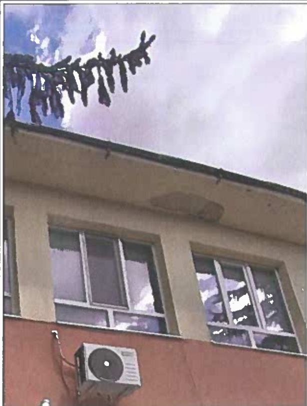
01. обрушена мазилка под стреха
