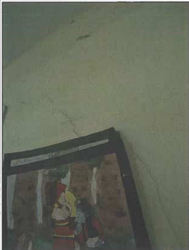
13. пукнатини в мазилка
