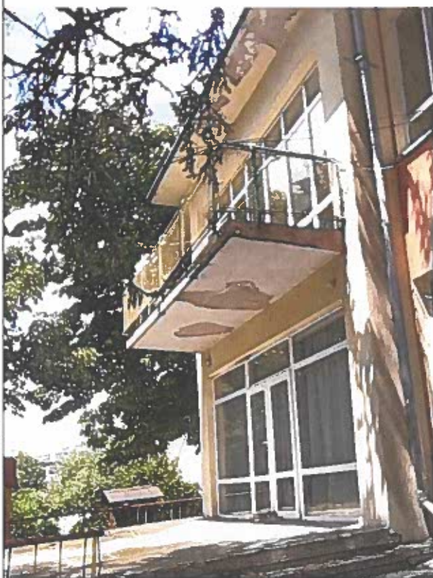
23. обрушена мазилка под стреха
