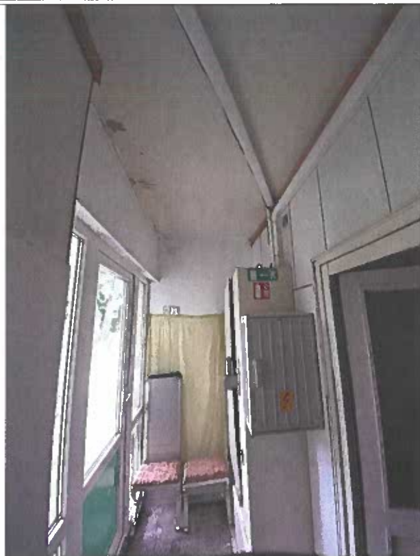
02. обрушена интериорна мазилка
